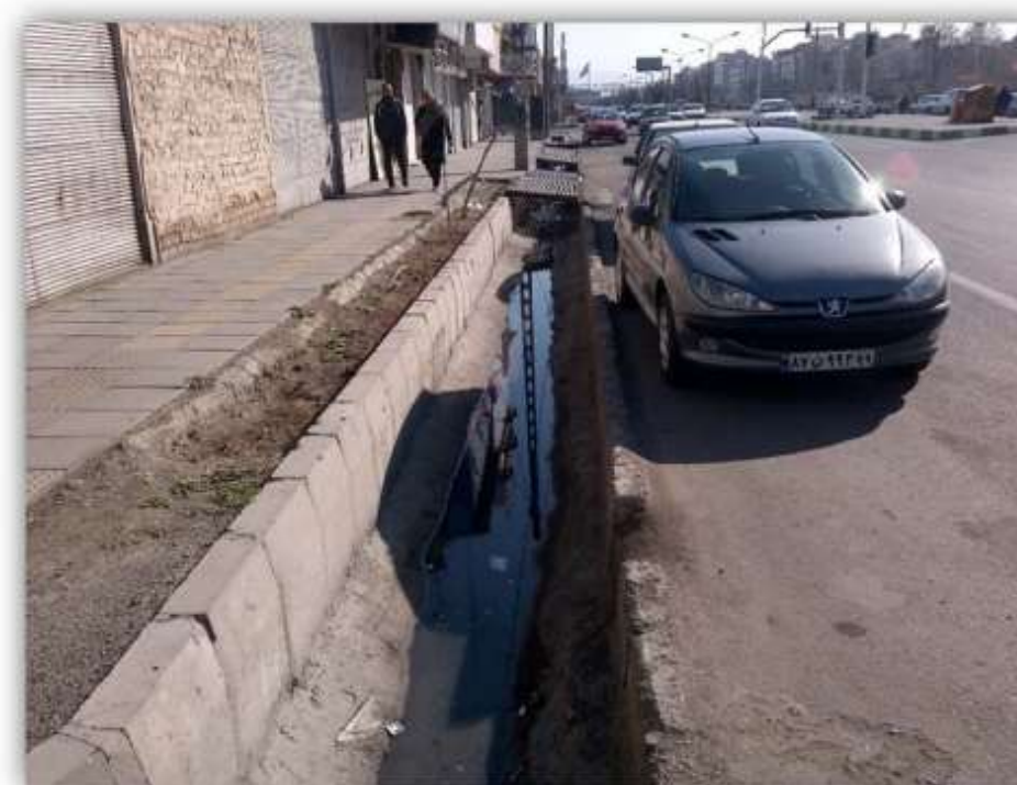
شکل ۳) وجود جوی عمیق بدون حفاظ مناسب
