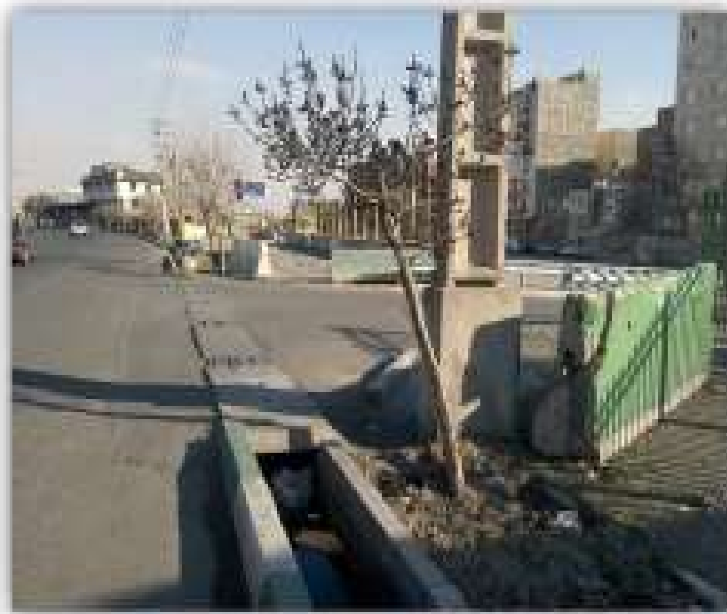
شکل ۱) مشکل طرح هندسی در تقاطع و نامناسب بودن پیاده رو
