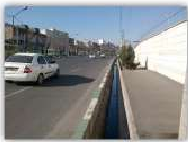
تکلیف ۶۶ نمونه ای از جوی عمیق در جهت شرق به غرب قبل از خیابان مطری
